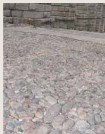
Figura 269. Borrillo construido con cantos rodados de gneis y granito en las inmediaciones del acueducto. (Foto: J.F. Martín Duque)
