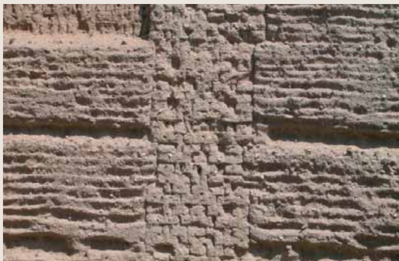
Figura 235. El adobe, bloques de pequeñas dimensiones (en el centro de la imagen), se utilizaba para los muros de los pisos altos, o relleno de entramados de madera. Y el tapial, pared hecha con barro aprisionado en una gran 'caja' de madera, se utilizaba para muros y tapias de mayor espesor, generalmente en las partes bajas. En la fotografía, adobe y tapial aparecen combinados en la misma estructura, Codorniz. (Foto: A. Díez)
