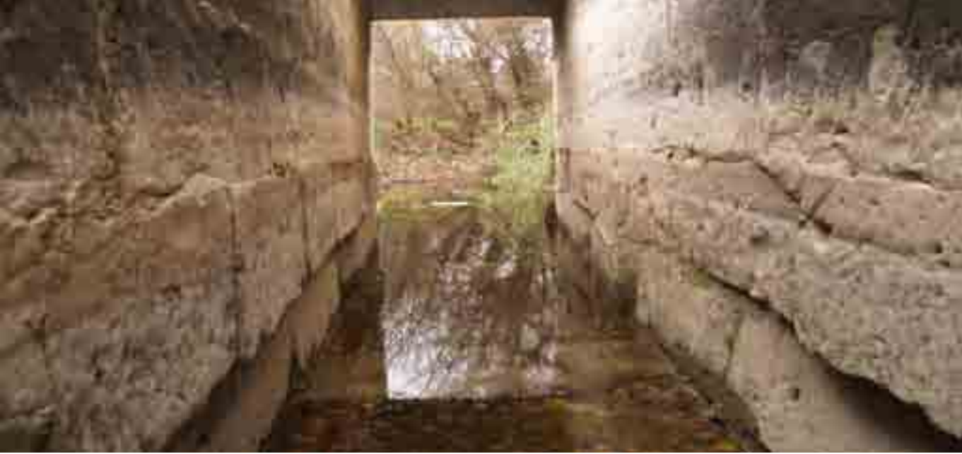
CANAL DONDE SE ENCUENTRA LA RUEDA DE PALETAS.
