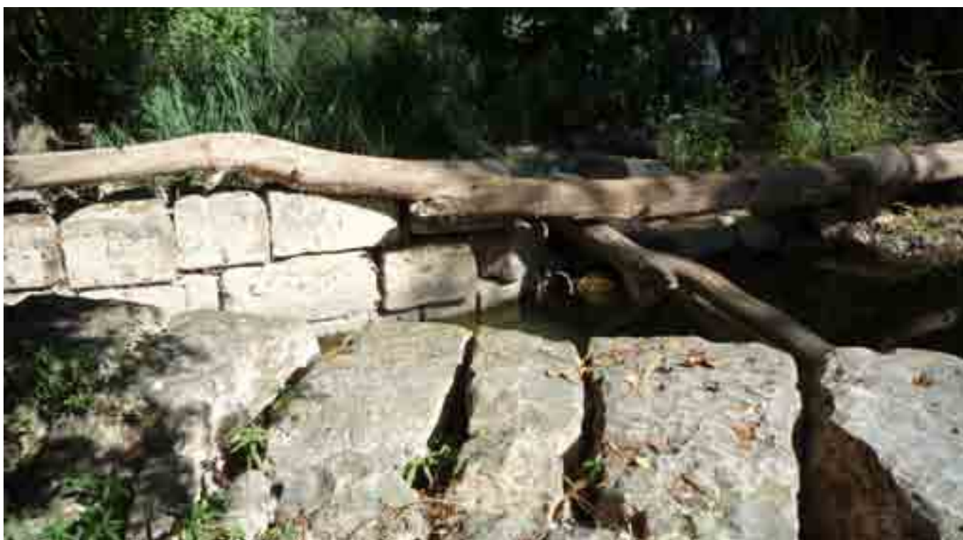
ACUMULACIÓN DE TRONCOS EN LAS ENTRADAS DE LOS CANALES.
