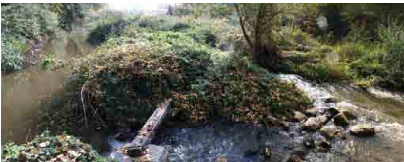
RESTOS DE UNO DE LOS CUBOS BAJOS CUBIERTO POR LA VEGETACIÓN.
