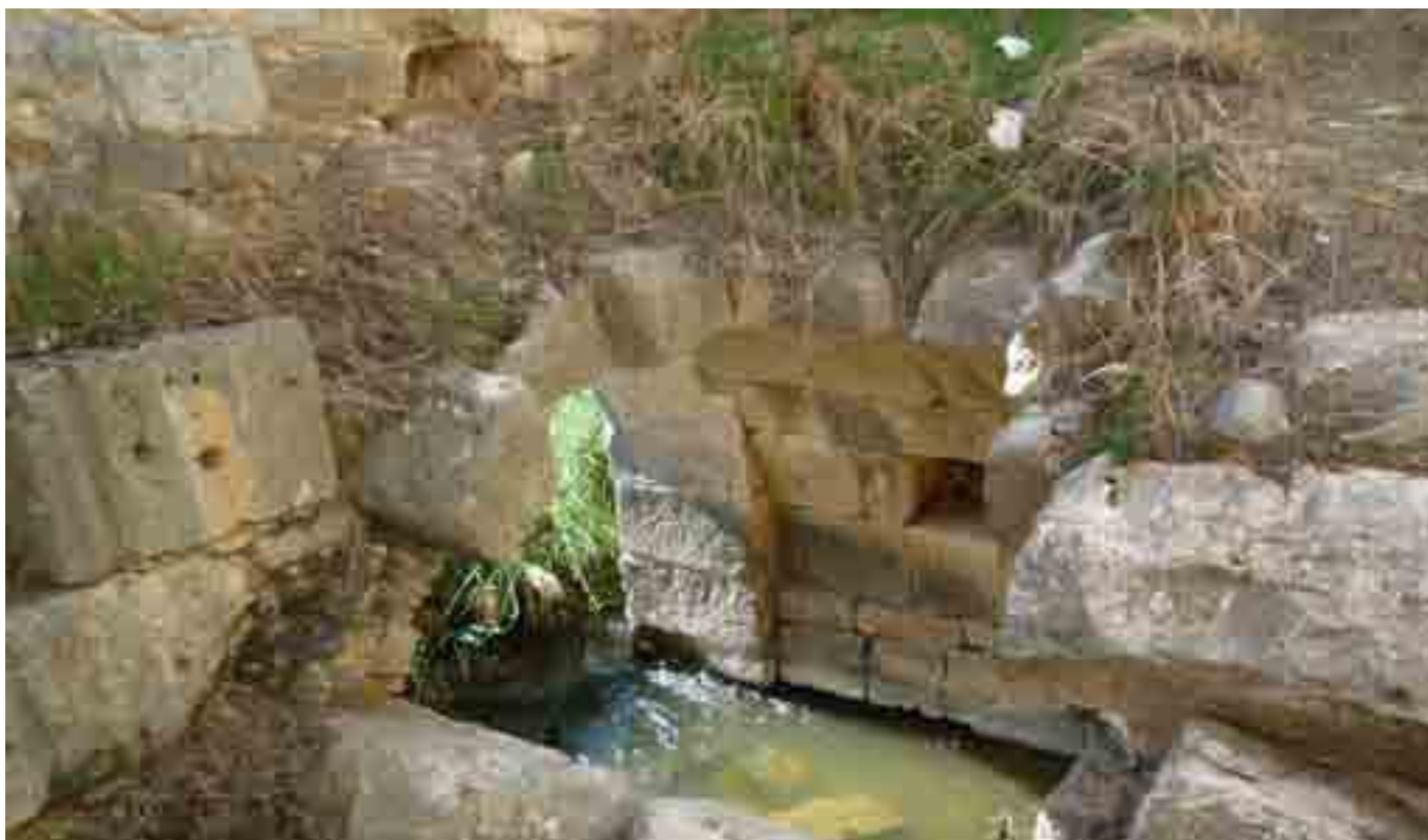
DETALLE DE LA BÓVEDA DE PIEDRA DE UNO DE LOS CÁRCAVOS, DESDE EL INTERIOR DE UNO DE LOS CUERPOS.
