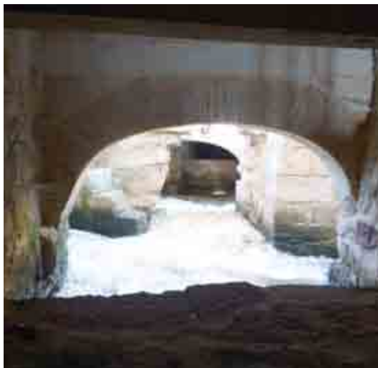
VISTA DESDE EL INTERIOR DEL CÁRCAVO.
