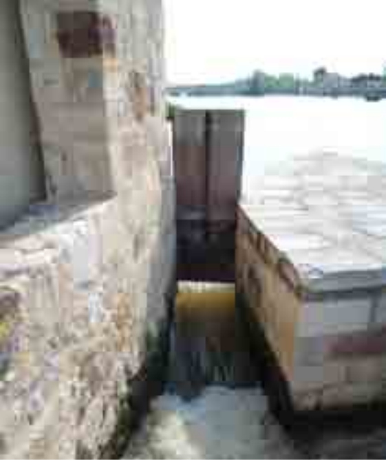
COMPUERTA DE CANAL DE ENTRADA.
