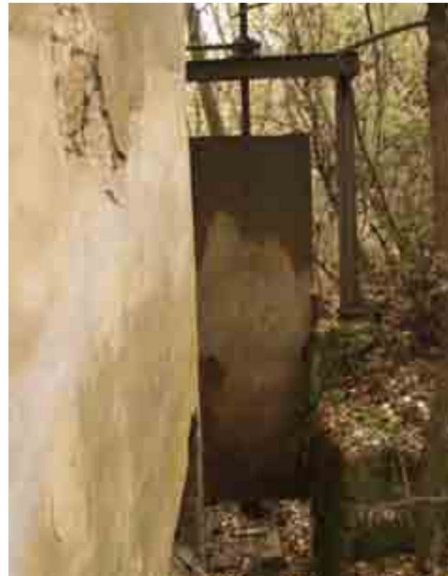
COMPUERTA DEL CANAL DE LA RUEDA DE PALAS.
