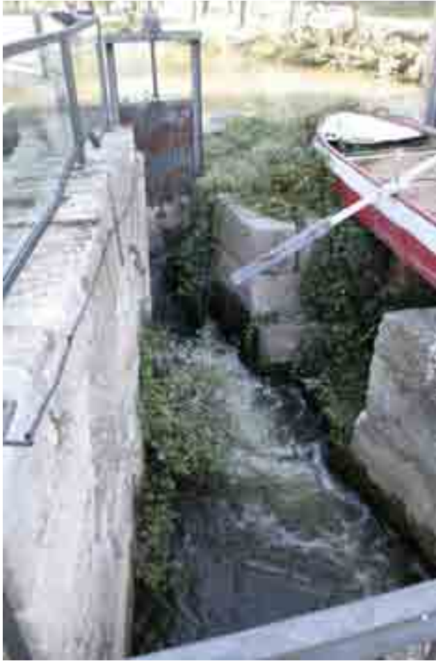
DETALLE DE UNO DE LOS CANALES Y EL CÁRCAVO.
