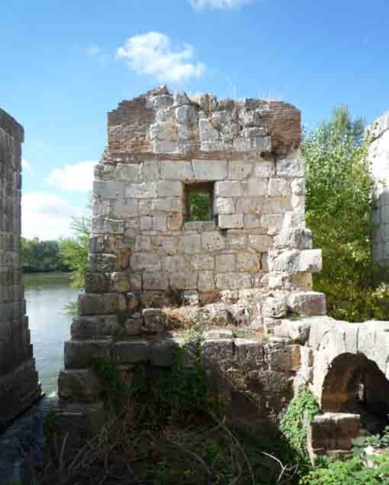
INTERIOR DERRUIDO DEL CUBO INTERMEDIO.
